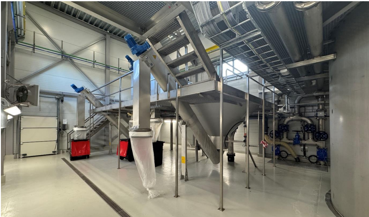
Bilde 2: Forbehandling inne på Eidskog renseanlegg
